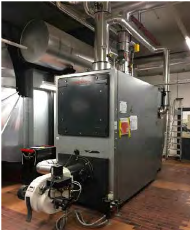
Abbildung 1: Bestehender Wärmeerzeuger (Öl/Gas)
