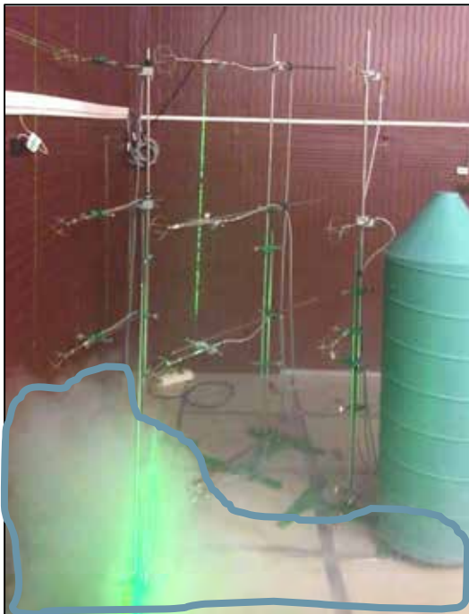
Abb. 2: Unterflurkonvektor IST-Zustand im Kühlbetrieb
