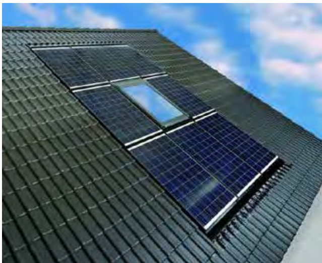
Abb. 1: PV-Anlage mit integriertem Dachfenster, Quelle: VELUX Schweiz
